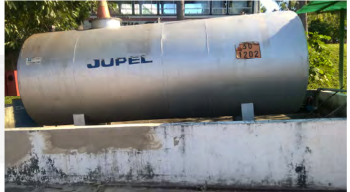
Foto 02: Tanque de diesel
