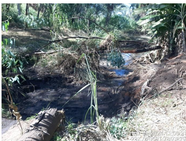
Foto 31: Tanque final de decantação de águas pluviais.
