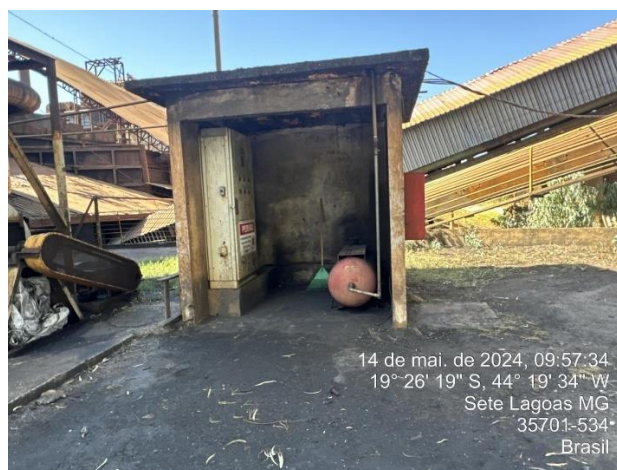
Foto 10: Área do compressor 02
