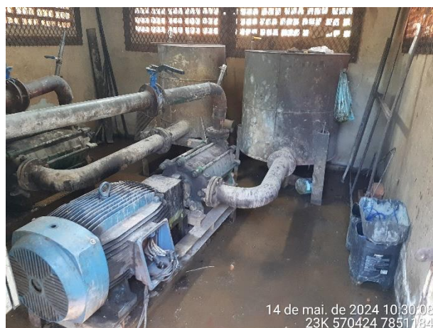
Foto 34: Interior da casa de bombas.
