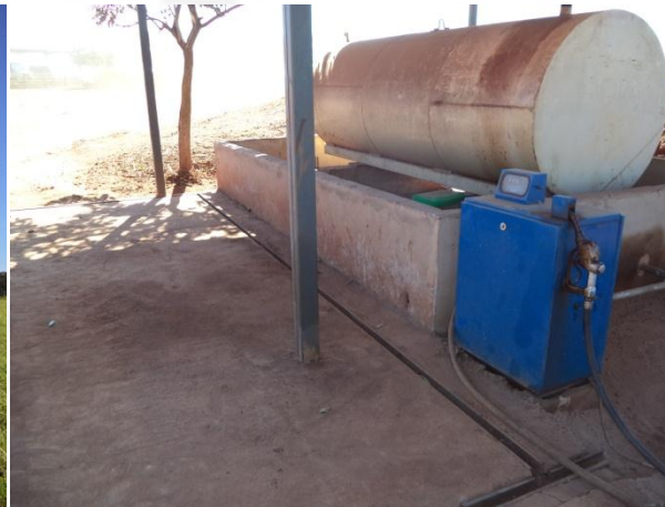
Figura 6. Ponto de abastecimento
