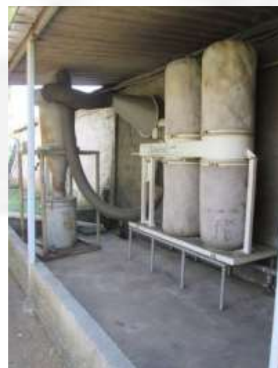
Figura 10: Filtros e contenção da cabine de jateamento.
