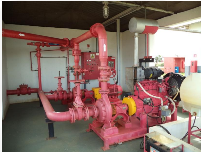
Foto vistoria: parte do sistema de combate a incêndios
