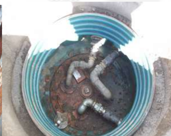
Foto 04. Câmara de acesso à boca de visita
