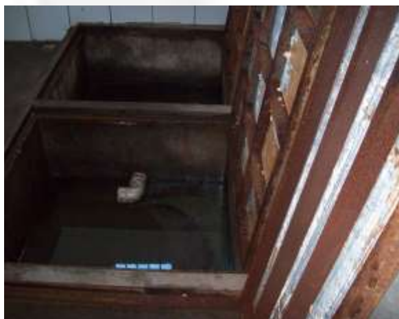
Foto 03. Caixa Separadora de Água e Óleo
