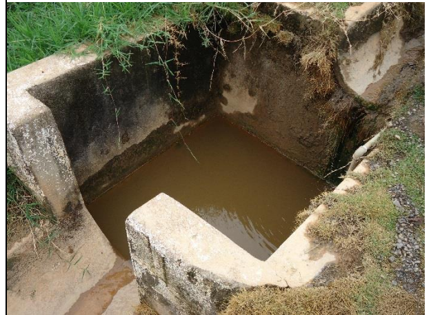
Foto 02. Caixa de decantação
