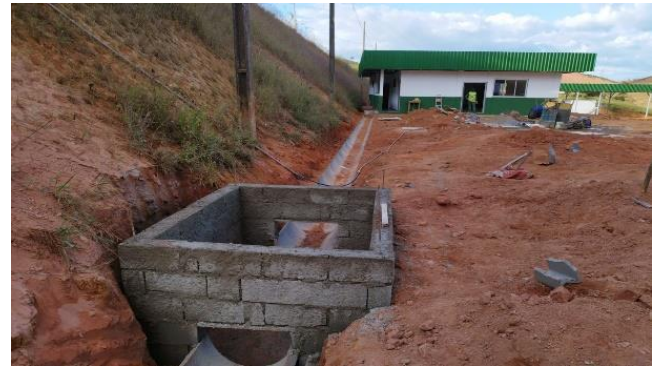
Sistema de drenagem pluvial/caixas de passagem. Revegetação de talude mediante microcoveamento e hidrossemeadura.
