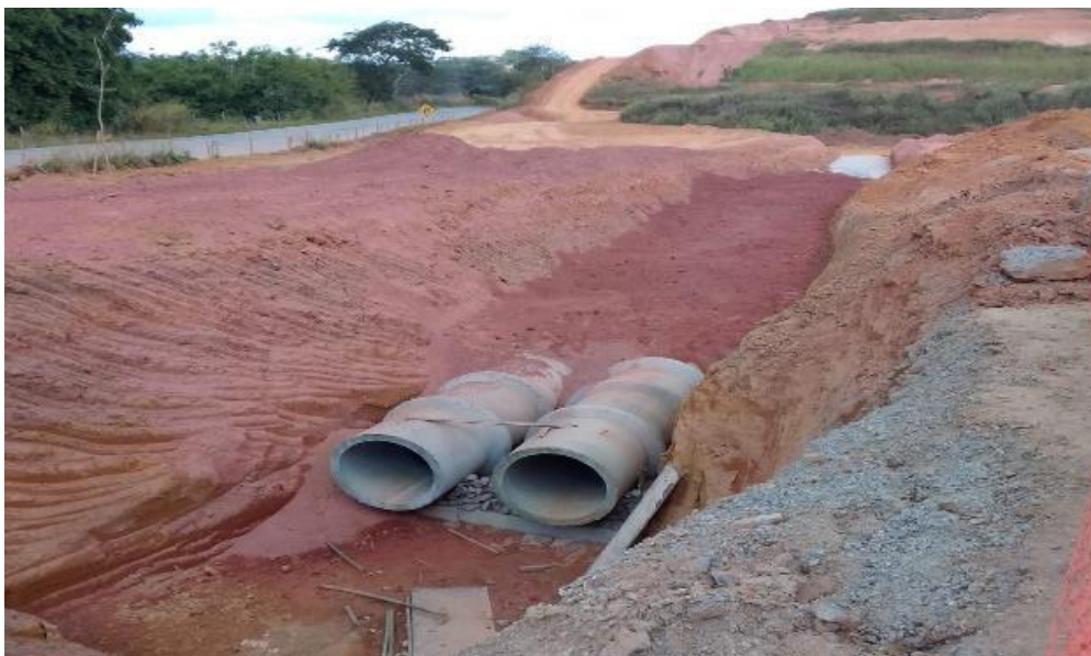
Manilhas do sistema de drenagem pluvial. Por sobre essa área será realizada a construção do trevo de acesso ao empreendimento.
