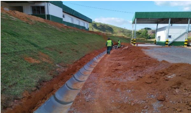
Canaletas de drenagem de água pluvial/revegetação de talude com placas de grama (aos fundos à esquerda prédio administrativo e à direita prédio da balança).
