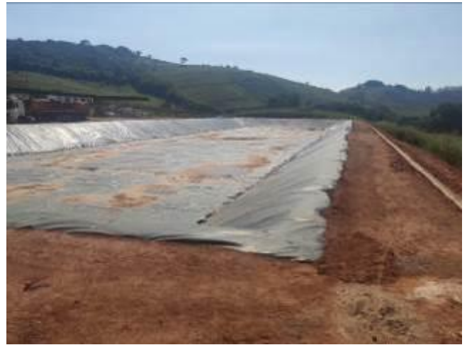
Lagoa facultativa (de acordo com o projeto inicial) mas devido às modificações propostas na ETE será destinada para armazenamento do efluente tratado.
