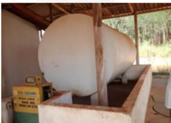
Foto 03. Tanque de armazenamento de combustível
