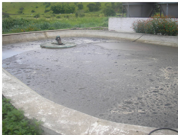
Foto 04. Tanque de Equalização
