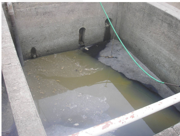
Foto 03. Tanque primeiro de tratamento de efluente
