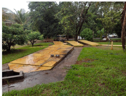
ETE – Tratamento Preliminar
