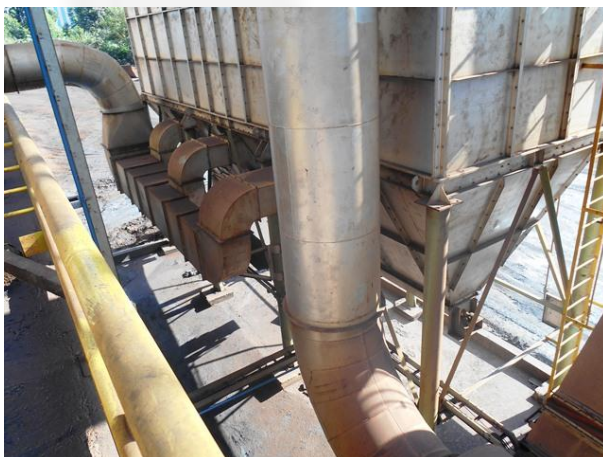
Foto 03. Filtro de mangas para tratamento dos efluentes atmosféricos.
