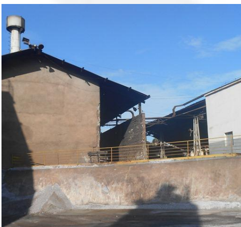
Foto 09. Área impermeabilizada e coberta para armazenagem do material particulado retirado do filtro de mangas.
