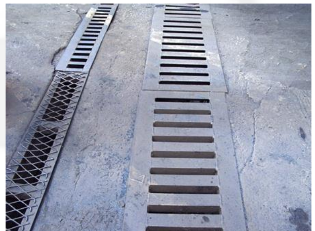
Foto 10. Sistema de drenagem pluvial.
