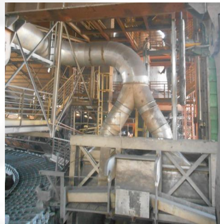
Foto 02. Coifa e dutos para captação dos efluentes atmosféricos gerados.
