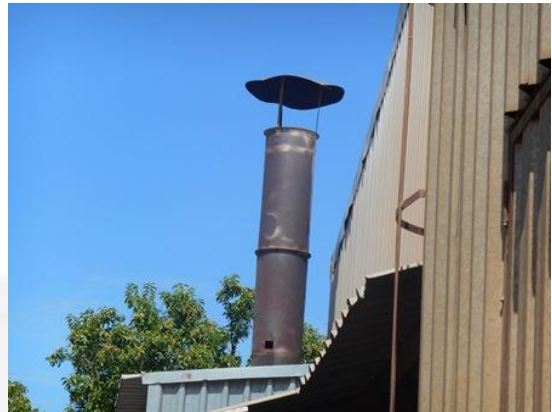
Foto 6 – Chaminé da Caldeira
