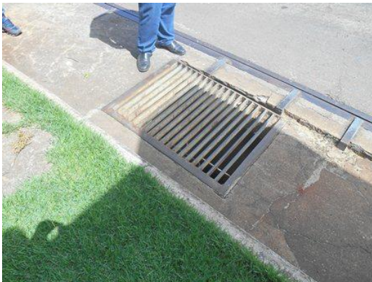
Foto 5 – Sistema de drenagem pluvial
