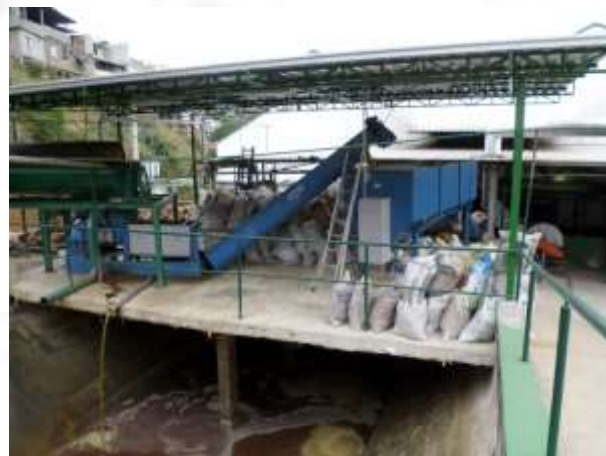
Foto 02. Vista do tratamento do conteúdo ruminal-efluente acumulado e encaminhado à ETE.
