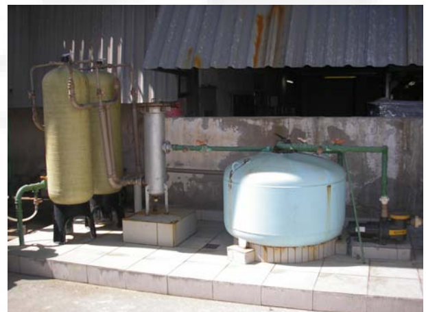
Foto 08. Estação de tratamento de efluentes.
