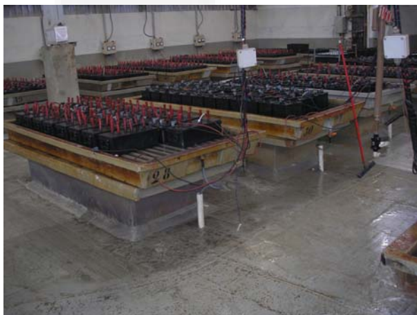
Foto 07. Carregamento das baterias.
