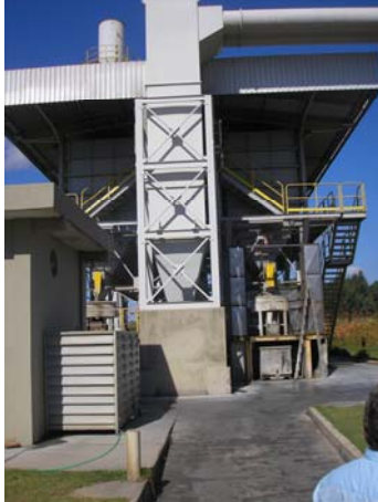
Foto 01. Tratamento das emissões atmosféricas.
