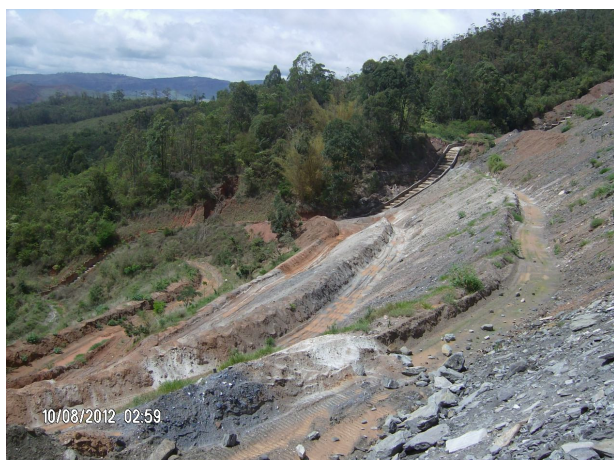
Foto 01 - Vista parcial do flanco leste da PDE03, onde se vê os bancos que serão envelopados pela ampliação e, ao fundo, a canaleta de drenagem.
