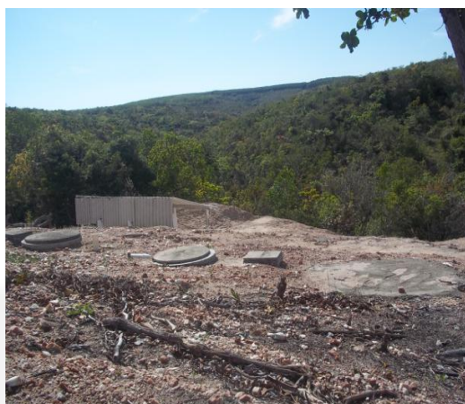
- Tratamento de esgoto.
