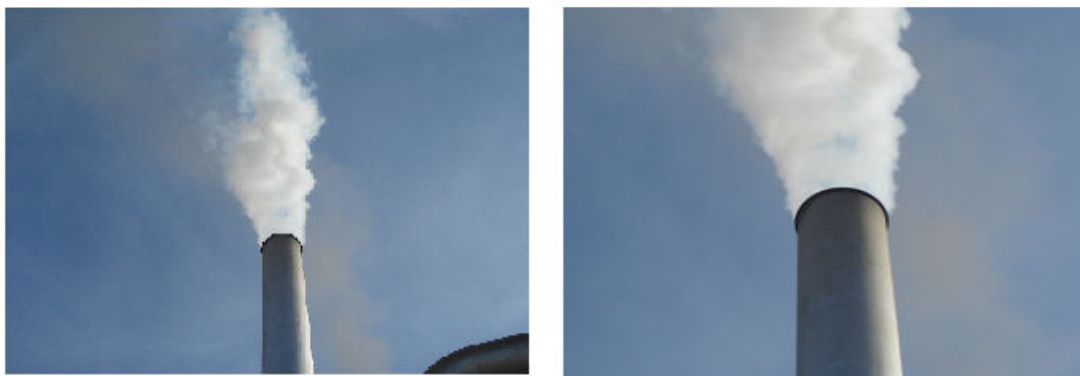
Imagens da emissão de fumaça, emitidas pelas caldeiras, após instalação de lavadores de gases
