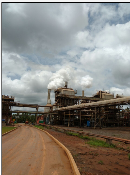
Conjunto de Caldeiras 1 e 2
