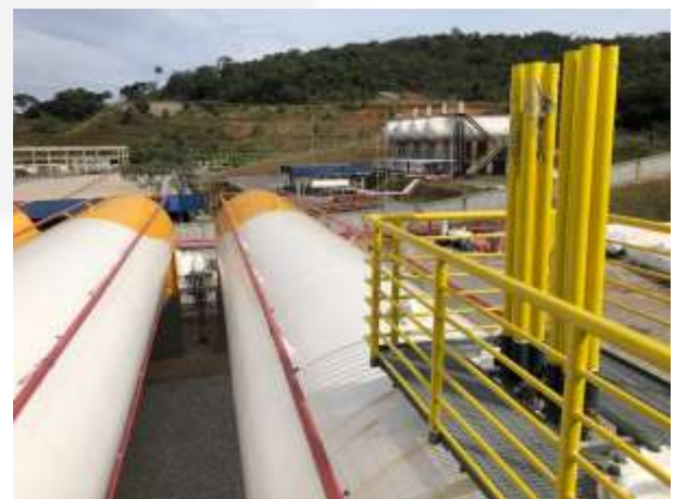
Foto 04. Vista superior dos dois novos tanques, com as válvulas de segurança à direita.
