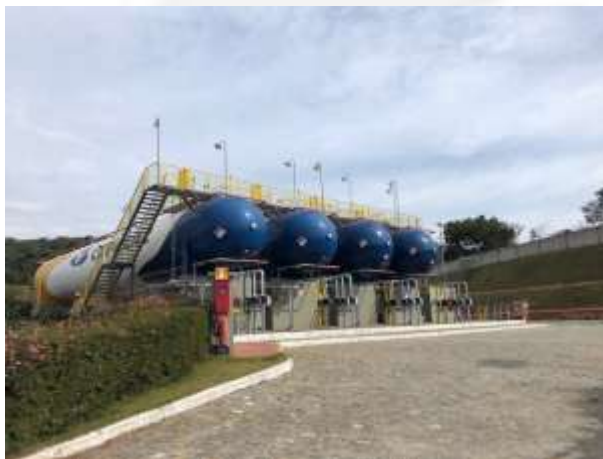
Foto 01. Tanques de armazenamento de GLP: dois em operação e dois objetos deste processo de LO .
