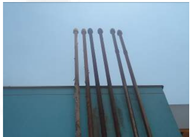
Foto 02. Respiros dos tanques com válvulas de retenção de vapores.
