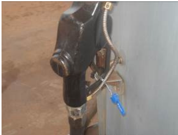
Foto 5. Bomba com Lacre, atestando a não operação da ampliação.
