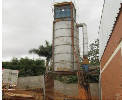
Figura 11: Silo de armazenamento de pó de madeira.
