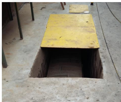
Figura 05: Caixa Separadora de Água e Óleo-CSAO
