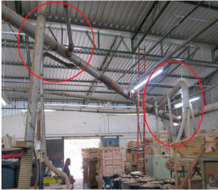
Figura 10: Sistema de controle de emissões de materiais particulados
