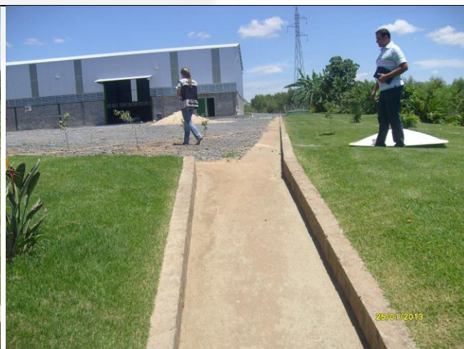
Foto 02. Sistema de drenagem pluvial
