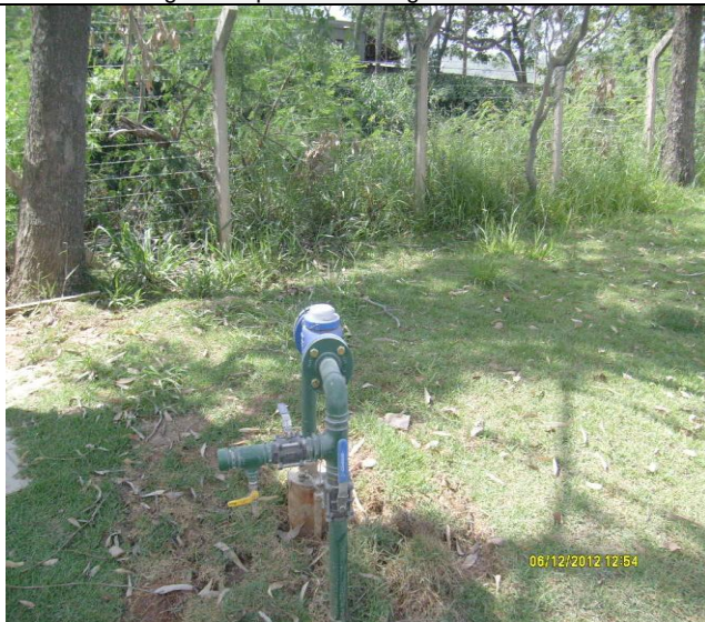
Foto 07: Poço tubular com hidrômetro instalado.
