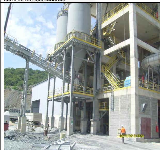
Foto 03: Filtros de manga instalados
