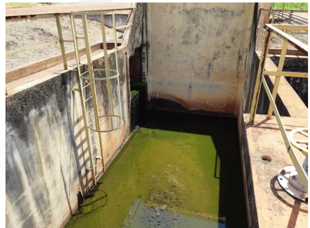
Foto 08. Recebimento de águas pluviais e efluentes industriais tratados
