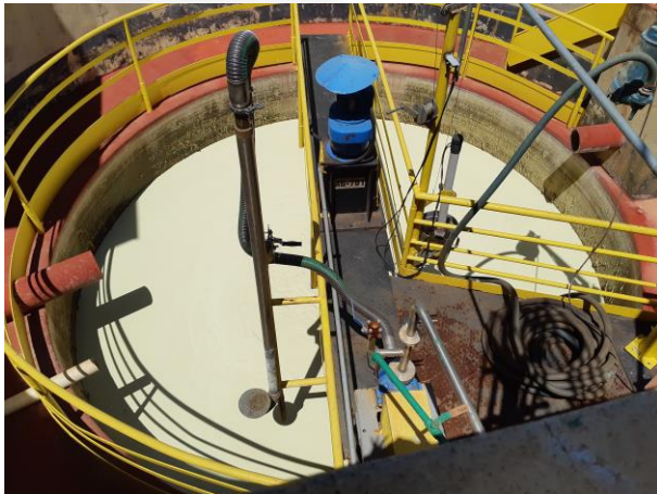
Foto 03. Tanque de equalização - ETE
