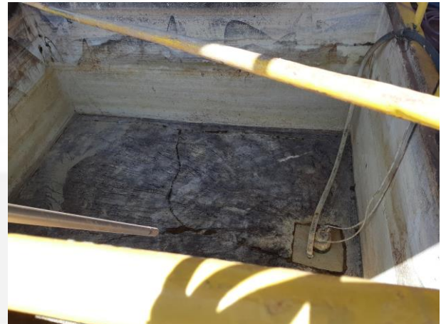
Foto 04. Fosso de lodo - ETE
