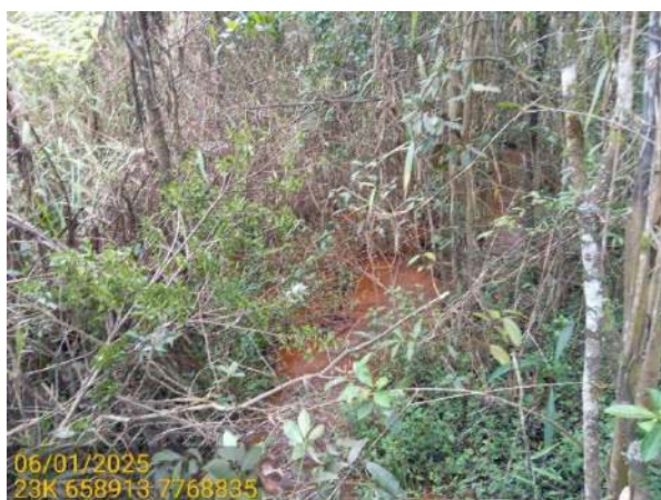
Foto 59. Drenagem ativa na área de influência da BR_0043.
