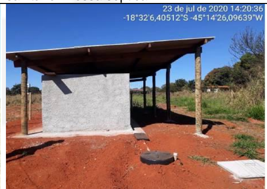
Foto 06. Canaleta da composteira com deságue em fossa séptica.
