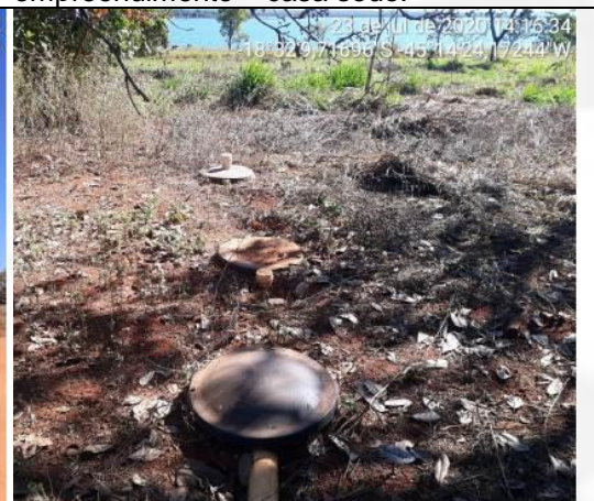
Foto 03. Sistema de tratamento do esgoto sanitário – fossa séptica.
