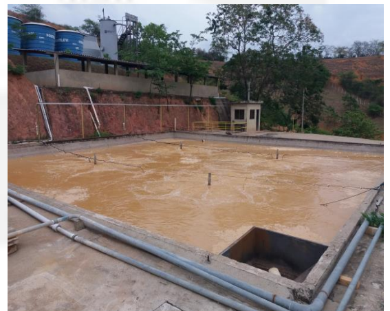
Figura 4: tanque de aeração
