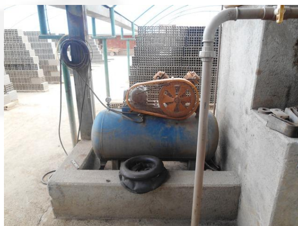
Foto 10. Compressor instalado em local impermeabilizado e com contenção.
