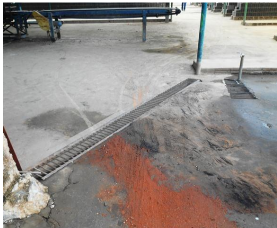
Foto 05. Sistema de drenagem pluvial
