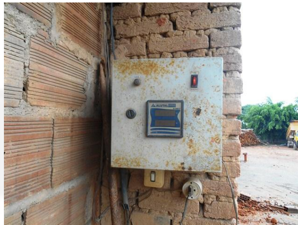
Foto 06. Termopar para controle de temperatura
