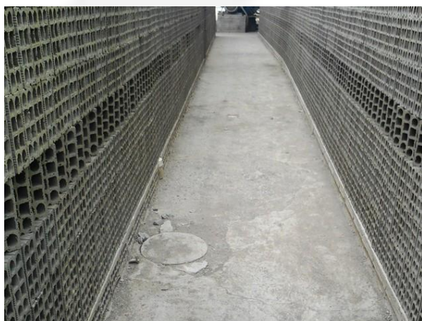
Foto 07. Sistema de tratamento de esgoto sanitário ETE.
