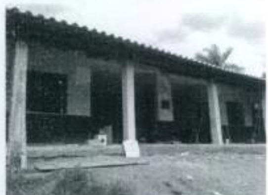
Figura 64 -- Escola Municipal Ana Diana. Ensino Fundamental (1ª a 4ª série) que está sendo reformada. Situação em 09/01/2013.
