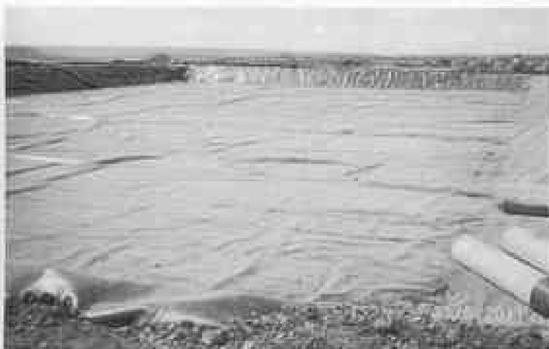
Foto 02: Tanque de armazenamento de águas residuais tratadas
