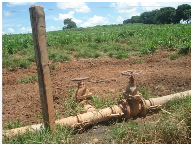
Sistema de Fertilização – Adutora Fixa.
