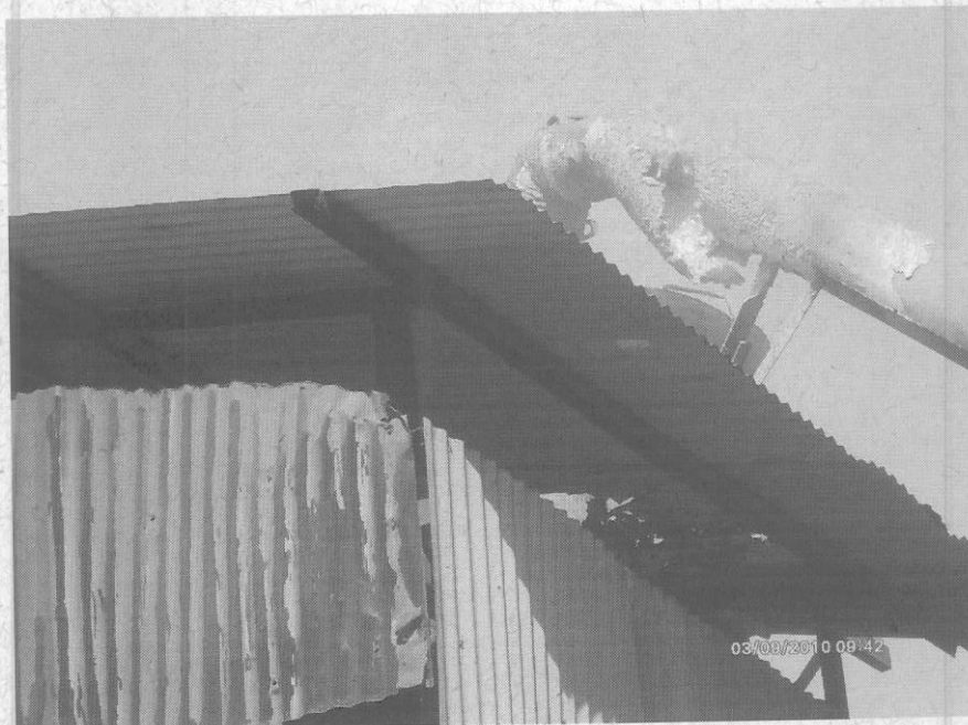
Imagem 01: Sistema de mitigação de efluente atmosférico danificado
