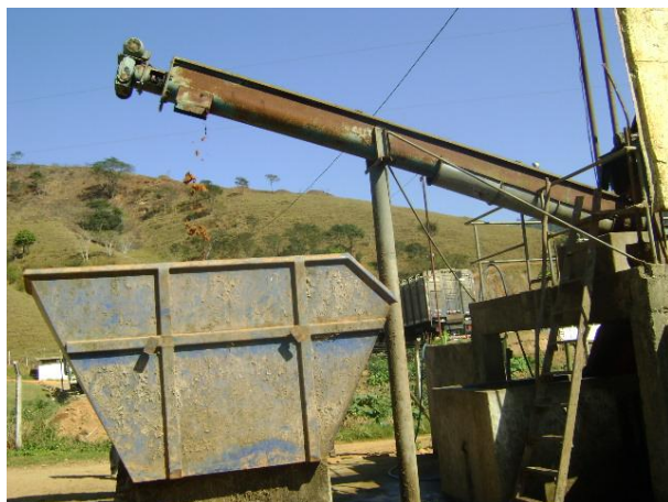
Foto 05. Sistema preliminar da ETE. Peneiração.
