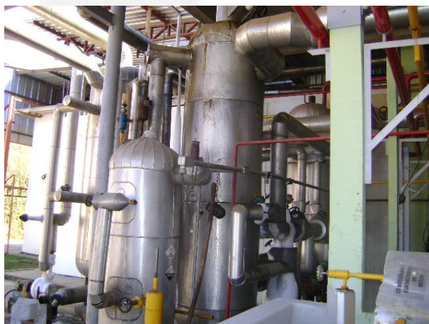
Foto 03. Sistema de refrigeração por Amônia.
