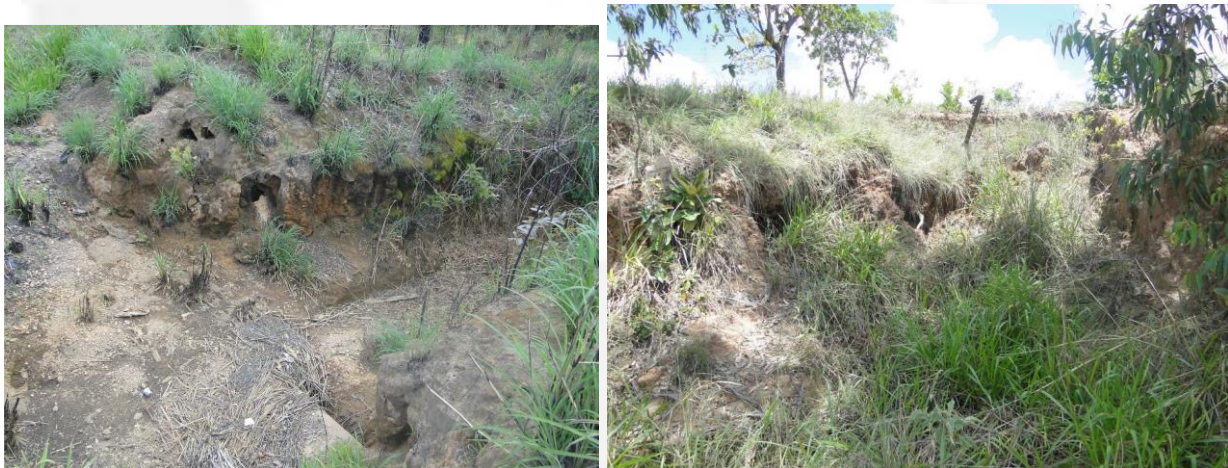
Figura 4-3 – Ravinas e sulco erosivo no trecho 1 (ref. Pontos 19 e 37)
