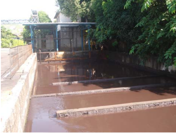
Figura 1: Tanque de decantação
