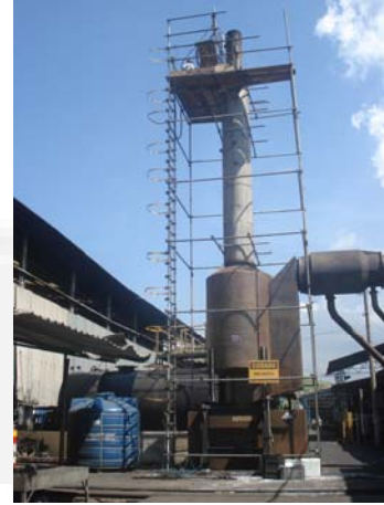
Figura 2: Chaminé do Lavador de gás
