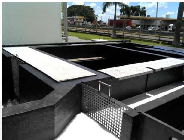
Foto 06: Estação de tratamento de efluentes (vista parcial); 23/12/2016.
