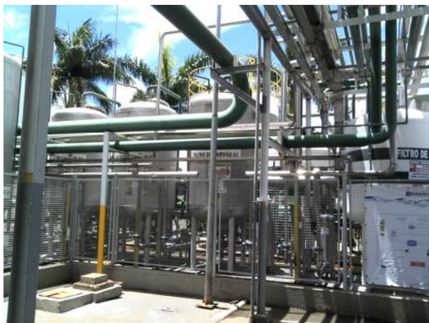
Foto 05: Estação de tratamento de água (vista parcial); 23/12/2016.
