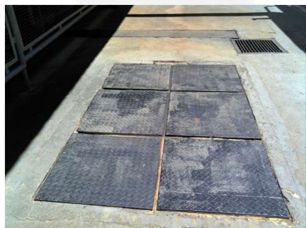
Foto 03: caixa separadora de água e óleo na área da caldeira; 23/12/2016.
