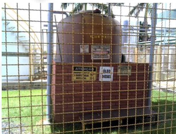
Foto 08: tanque de óleo diesel; 23/12/2016.
