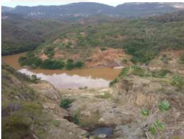
Vista do canal escavado onde será o vertedouro da barragem. Ao fundo, área de empréstimo de material terroso.
