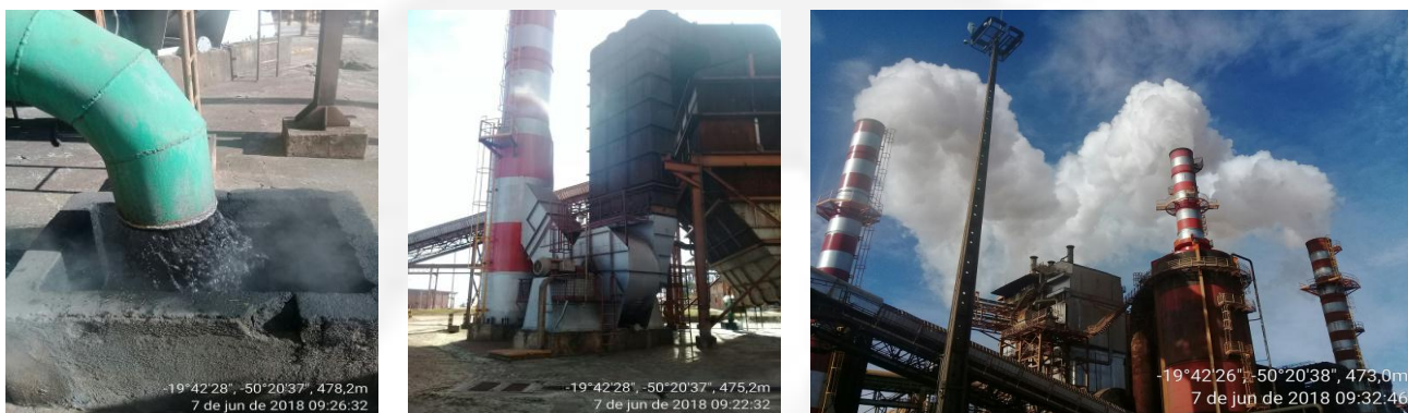
Figura 12 – Lavador de gases, ciclone e chaminés das caldeiras .
