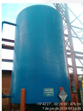
Figura 15- Tanque de armazenamento de óleo usado.
