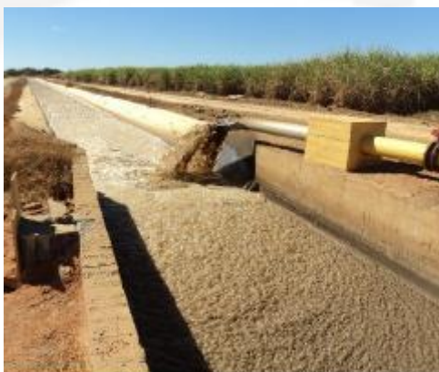
Fonte: PAV – GAIA anexado ao processo híbrido SEI nº SEI nº 1370.01.0018801/2021-50. Canal para transporte de efluente
