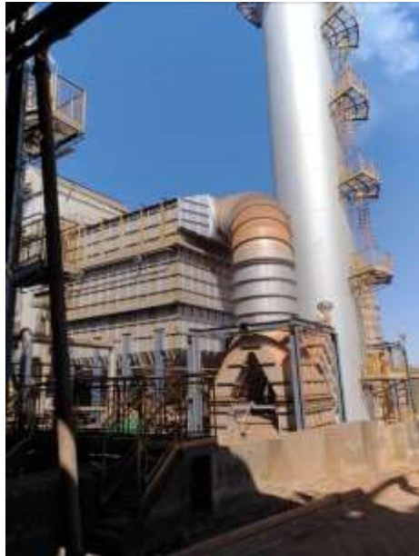
Foto 03. Lavador de gases caldeira
