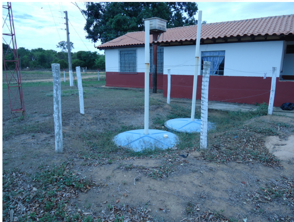
Foto 01. Fossas sépticas instaladas
