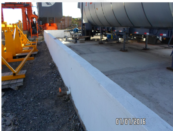
Foto 03. Registro instalado na saída da bacia de contenção dos tanques de CAP
