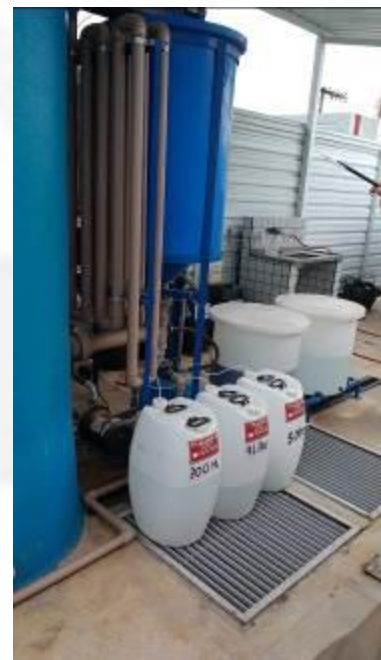
Foto 12. Estação de tratamento
