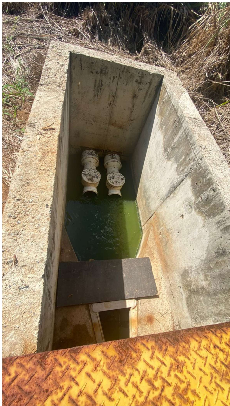
Figura 3- Foto evidenciando coloração esverdeada na saída da ETE da indústria após tratamento. Fonte: Autoria própria (11/2026)
