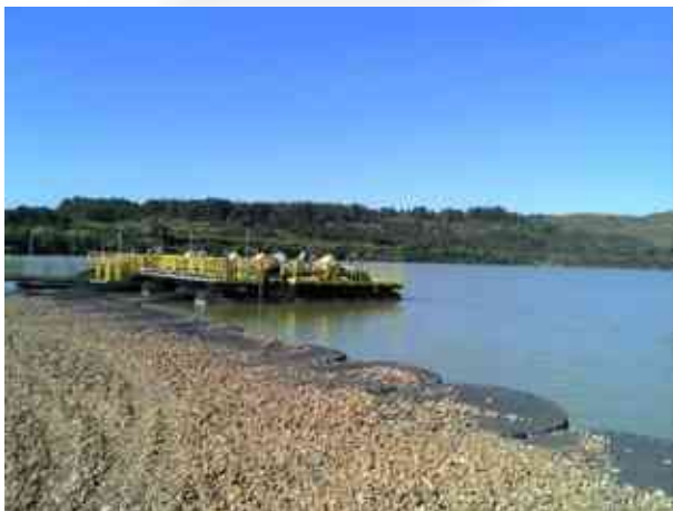
Foto 06. Balsa de captação de água – recirculação.
