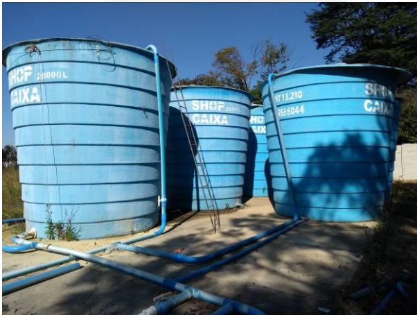
Foto 09. Reservatórios de água
