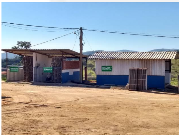
Foto 05. Geradores de energia.
