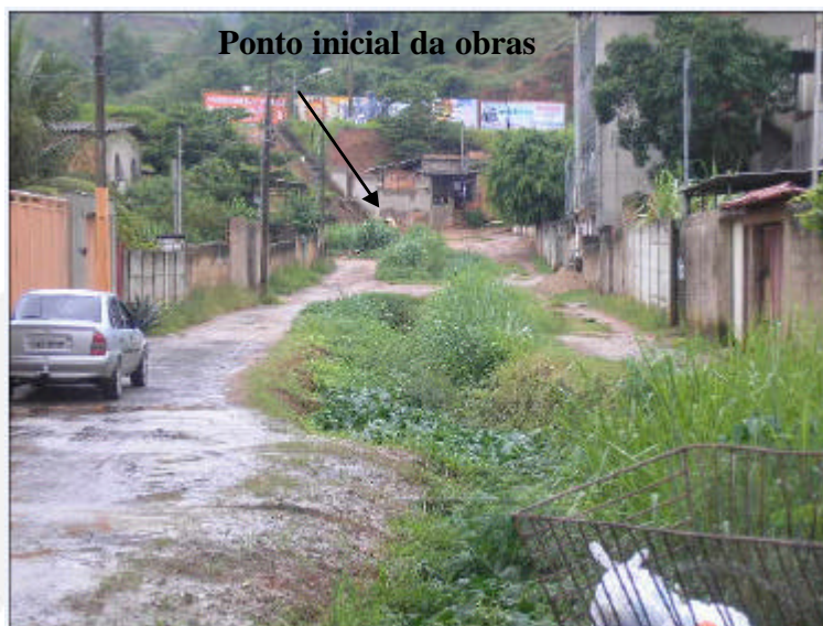
Foto 01: Vista parcial da área onde se dará o início das obras de canalização do afluente do Córrego Caladinho (trecho será construído com manilhas).
