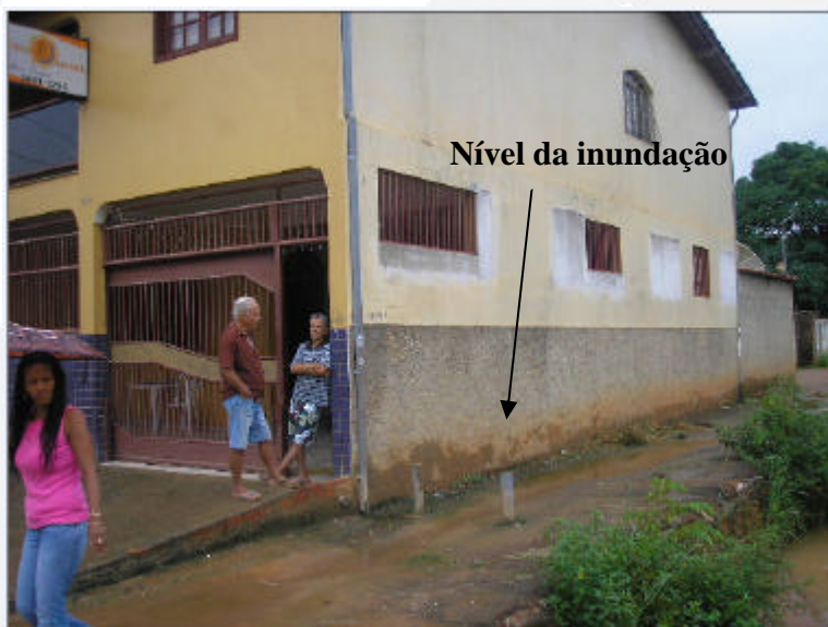
Foto 04: Vista do nível da inundação deixada na parede pelo afluente do Córrego Caladinho.
