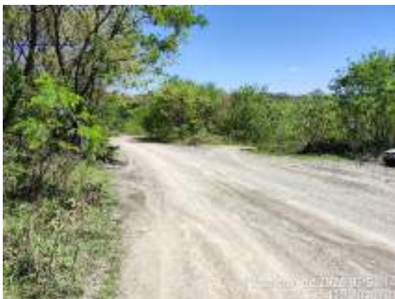
Foto 7: Acesso não pavimentado.
