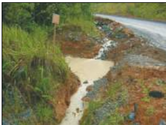
Foto 6: Exemplo de sistema de de drenagem em vias de acesso compostas por canaletas e bacias de decantação.
