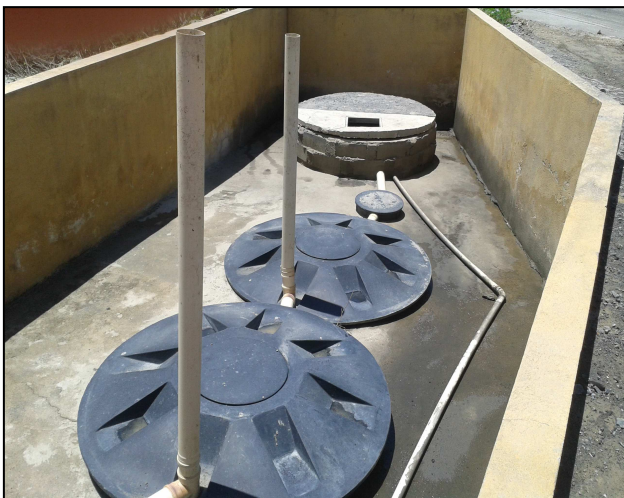
Sistema de Tratamento de Efluentes
