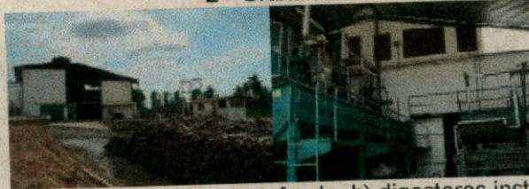
a) lavadores de gases ao fundo b) digestores instalados
